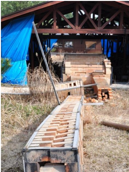
震災で倒壊した登り窯の煙突 2011年3月24日撮影
