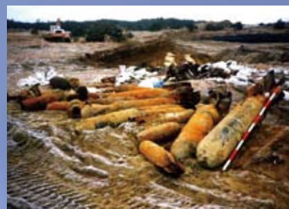
建設中に発掘された不発弾
